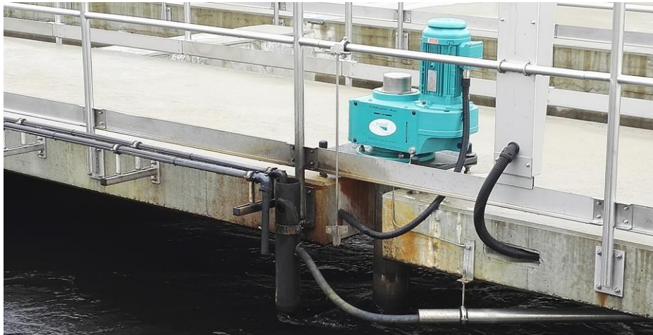
Abbildung 1: Das Fällmittel wird zusammen mit der PAK dosiert, damit es sich optimal einmischt.
