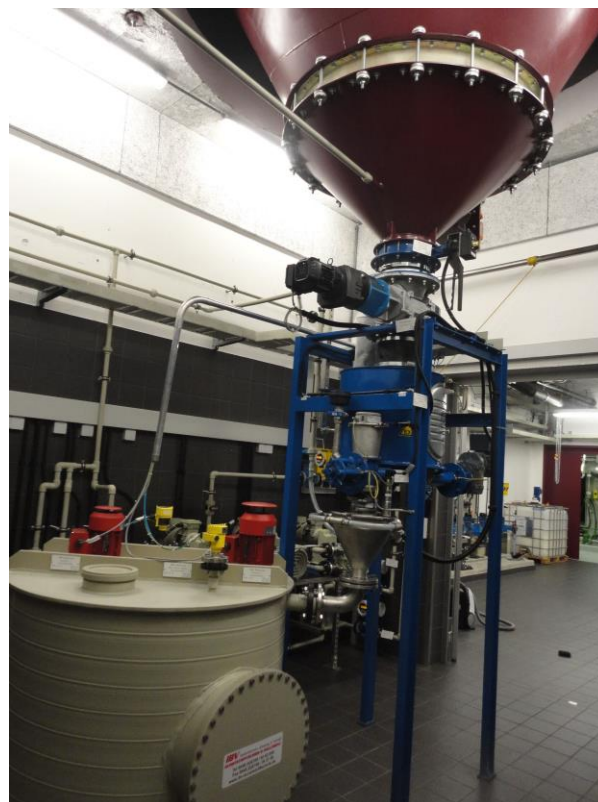
Figure 6 Station de dosage de CAP dans la STEP de Bachwis (Herisau).
