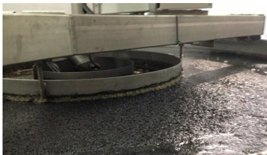
Illustration 2: détail de l'installation de flottation (A. Langbein).
