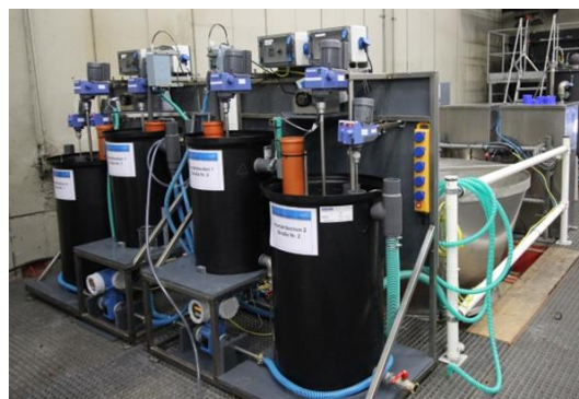
Illustration 6: réacteurs de contact de l'installation d'essai à deux lignes du Centre de Compétences (image: KomS).
