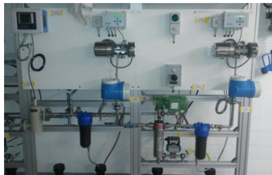
Abbildung 3: UV-Messung auf der ARA Neugut (Foto: J. Fleiner).
