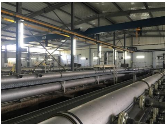
Abbildung 6: Membranbiologie der Kläranlage Kaarst-Nordkanal
