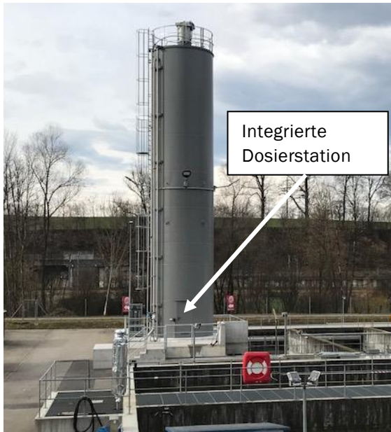
Abbildung 2: PAK-Silo ARA Wetzikon
