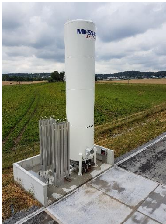
Abb. 8 : Lagertank für Flüssigsauerstoff auf der ARA Eich, Bassersdorf
