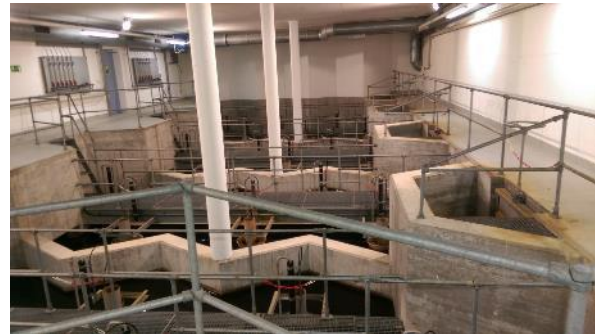
Abb. 5 : bestehende Filtration der ARA Moos im System DynaSand
