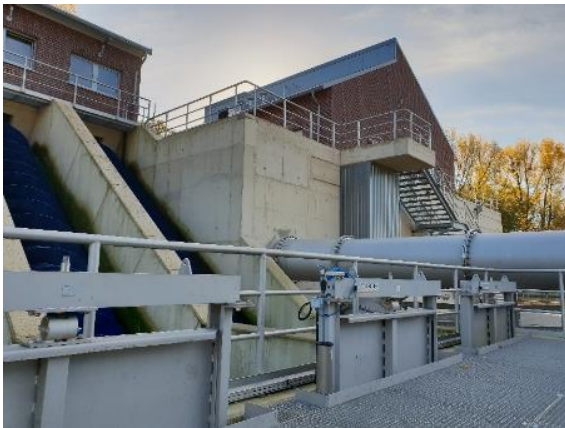
Abb. 10 : Ozonungsanlage Aachen-Soers (Quelle: WVER)
