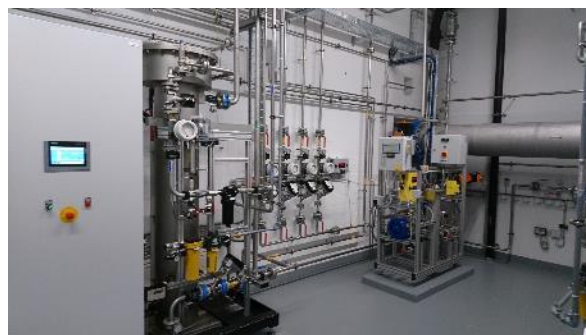
Abb. 7 : Blick in den Ozonerzeugerraum der ARA Eich, Bassersdorf
