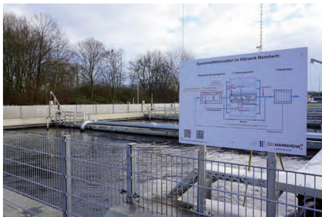
Abb. 5: Kontaktreaktor auf dem Klärwerk Mannheim
