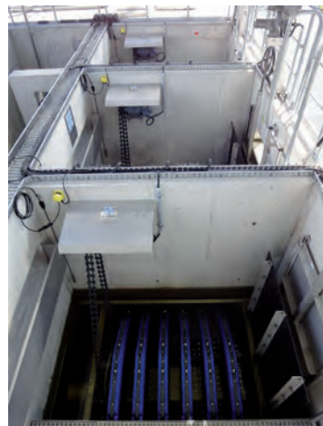
Abb. 2: Draufsicht auf die der Pulveraktivkohlereinigungsstufe nachgeschalteten Tuchfilteranlage der Kläranlage Laichingen
