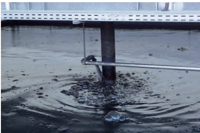
Abb. 4: Kläranlage Kressbronn-Langenargen: Zugabe der Pulveraktivkohlesuspension in den Kontaktreaktor
