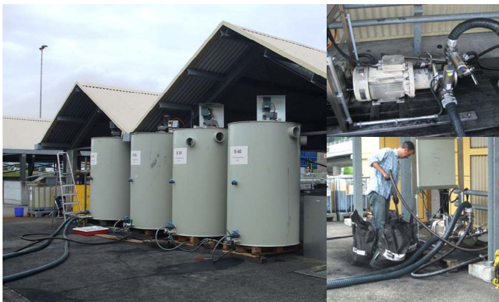
Abbildung 12 Dosier- und Aufbereitungseinrichtungen auf der Ara Kloten/Opfikon. Mit Hilfe eines Dispergator (Bild oben rechts) kann die Pulveraktivkohle aus den Transportsäcken staubarm abgesaugt und mit Wasser benetzt werden. Mittels flexibler Zu- und Ablaufleitungen können die PAK-Vorlagebehälter zur Befüllung gewechselt werden. Die Behälter selbst sind an eine Dosierstation - bestehend aus drei Mono-Pumpen - angehängt
