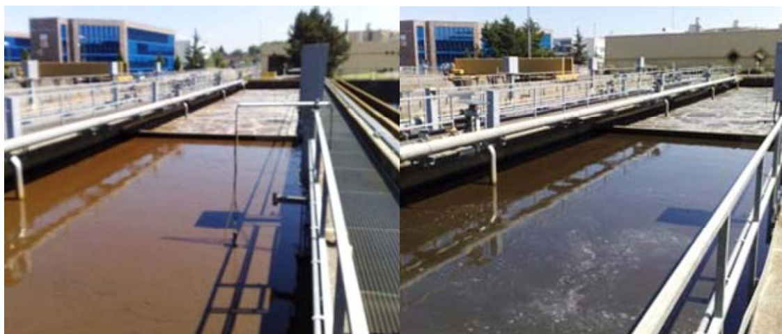
Abbildung 27 Das rechte Bild zeigt ein Belebungsbecken der Strasse Süd (mit PAK-Behandlung), deutlich ist der durch die Rückführung des Spülwassers aus der Filtration Süd schwarz eingefärbte Belebtschlamm im Gegensatz zur braunen Biologie Nord zu erkennen
