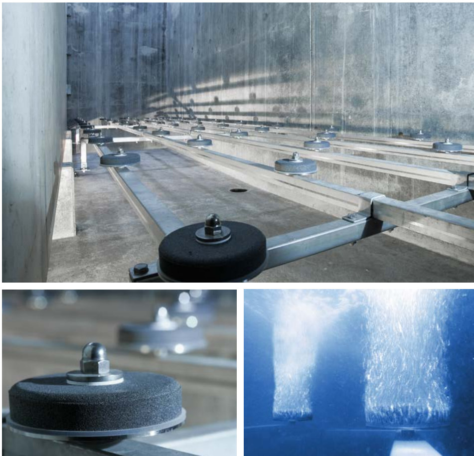
Fig. 2 Kammer 3 des Ozonreaktors der ARA Neugut; Ozoneintrag mit Keramikdiffusoren Chambre 3 du réacteur d'ozonation de la STEP de Neugut et diffuseurs poreux en céramiques à travers lesquels l'ozone est ajouté.
